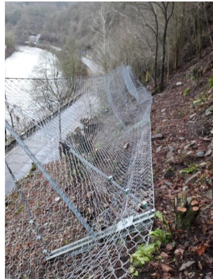
Figure 14. Chutes de blocs venant du versant : Ecran pare-blocs 50 kJ.
