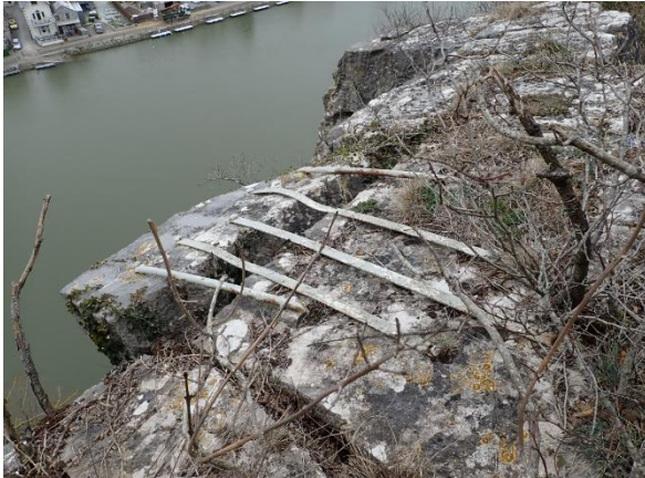
Figure 3. Anciennes barres d'ancrage sur les Rochers de Frêne, le long de la N647 à Lustin.
