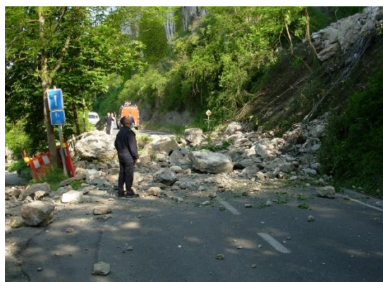
Figure 2. Effondrements rocheux survenus en 2008 sur la N647 à Lustin.
