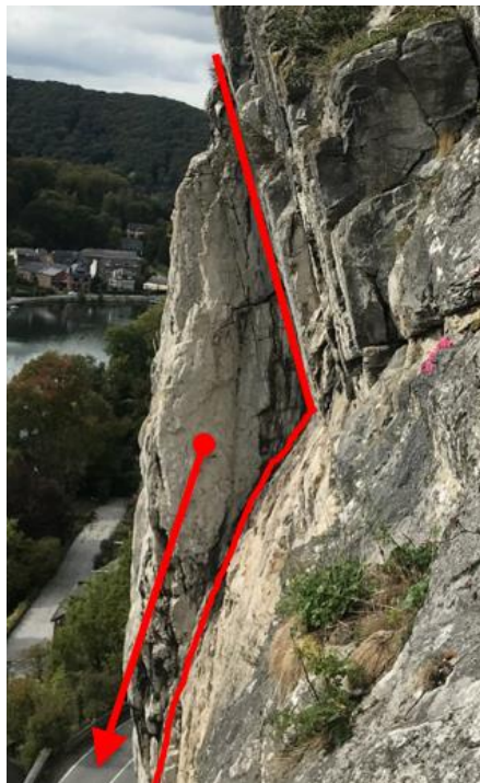
Figure 30. Importante strate rocheuse instable, d'une masse estimée à 1.000 tonnes.
