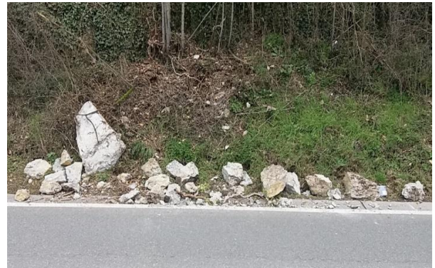
Figure 20. Chutes de blocs rocheux sur la N647 en 2018.
