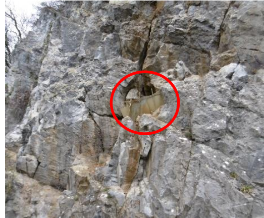
Figure 4. Anciennes plaques métalliques fixées par des ancrages verticaux, le long de la N947 à Godinne.
