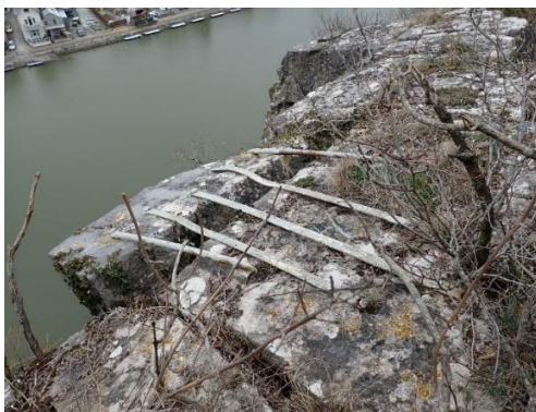
Figure 22. Anciens dispositifs de confortement (barres d'ancrage) observés sur la partie sommitale des Rochers de Frêne.
