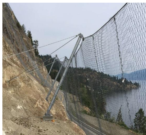
Figure 11. Écran défecteur posé en Suisse.
