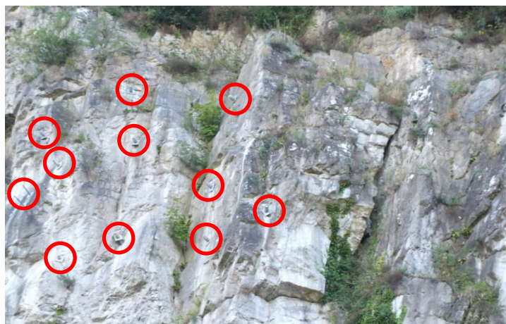
Figure 9. Ancrages passifs ponctuels le long de la N90 à Thon (Andenne).
