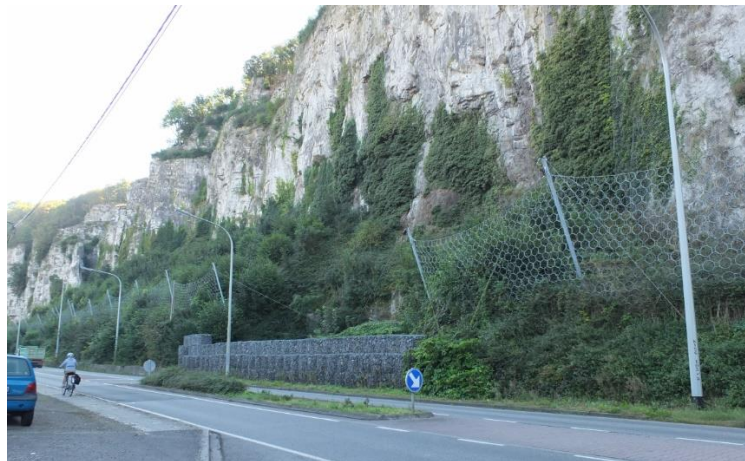
Figure 8. Filet pare-blocs dimensionné pour résister à une énergie de 3.000 kJ et merlon de gabions (partie centrale de la figure) posés le long de la N90 à Thon (Andenne).
